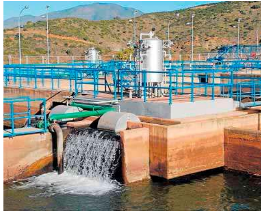
Planta potabilizadora del Verde, en Marbella. JOSELE
